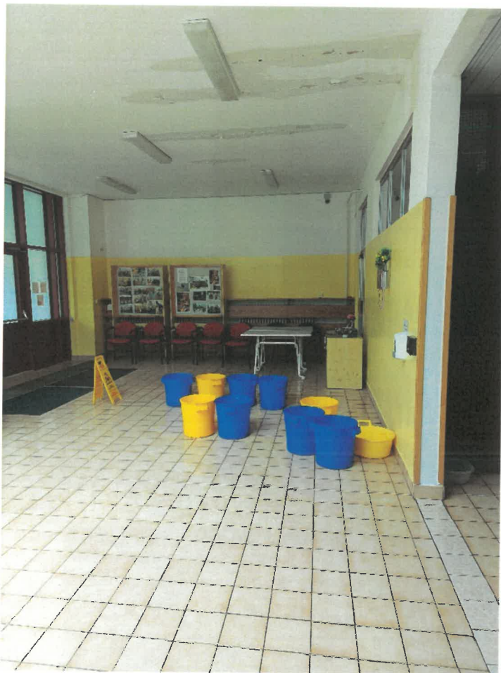
Zatékání do nově vymalovaného vestibulu v průběhu prací (srpen 2020)
